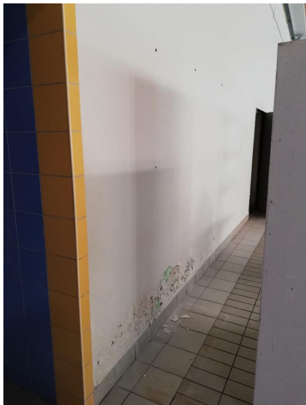
Rysunek 21 - uszkodzenia ściany natrysków od strony basenu sportowego do naprawy
